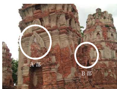
写真-5 方角で劣化状況の異なる仏塔
