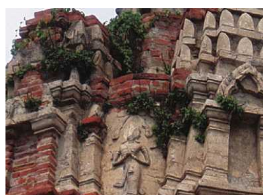
写真-4 仏像のレリーフが危険な状態にある仏塔(植物の繁茂も気になる)
