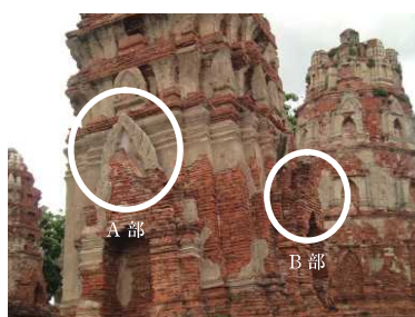
写真-5 方角で劣化状況の異なる仏塔
