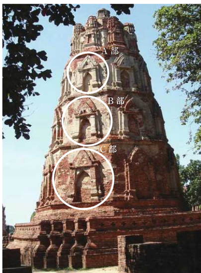
写真-8 高さ方向で異なる劣化状況
