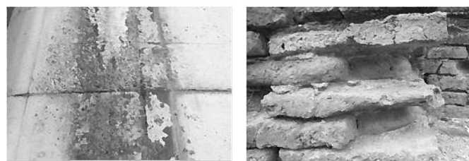
(a) コンクリートの凍害劣化 (b) 煉瓦の塩類風化
